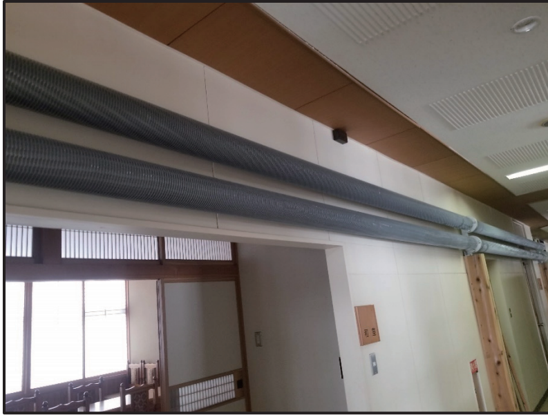
写真 2.4 廃校を活用した事業所内の暖房用配管
