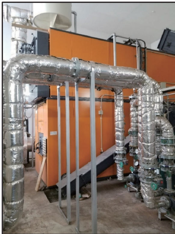
写真 2.1 庄司製材所で使用しているシュミット社のバイオマスボイラー
